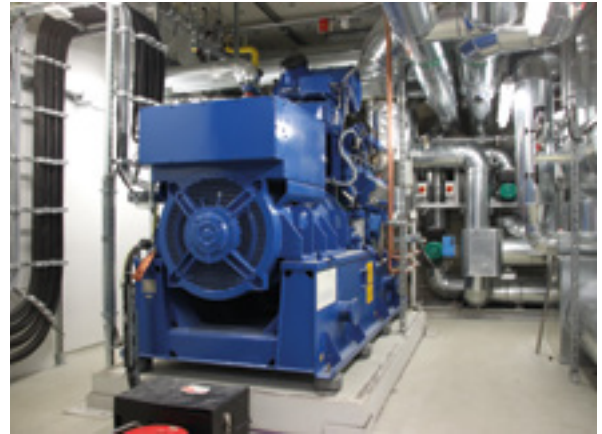
Das neue Blockheizkraftwerk des MDR.
